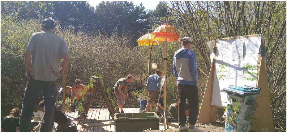
Abbildung 3: Gemeinsames Bauen am Inselgarten, im Vordergrund eine Pinnwand mit angepinnten Plänen (eigene Aufnahme)
