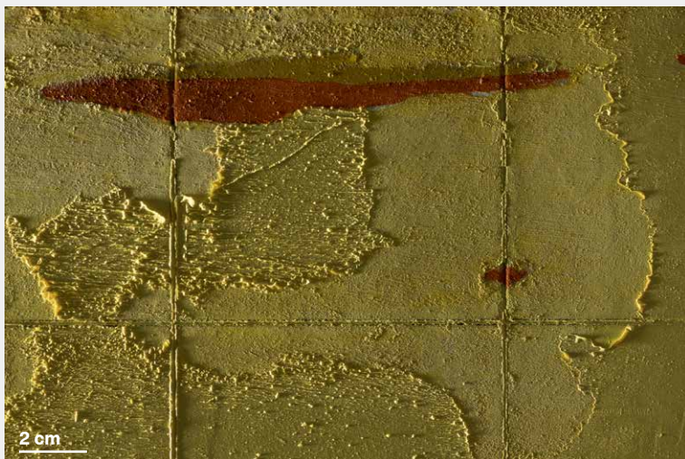
Abb. 4.11 Detail Malschichtschaden im Streiflicht.
