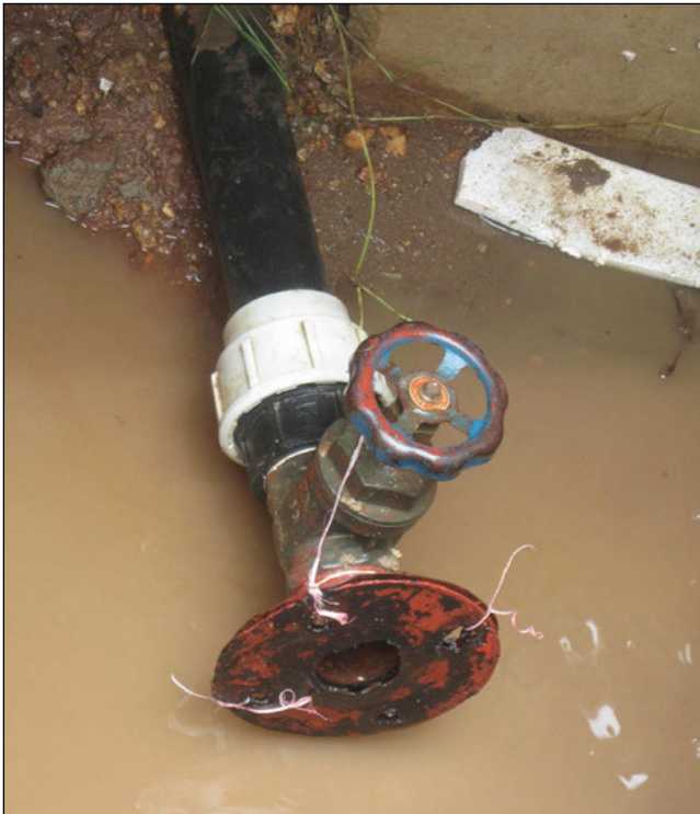
Abb. 2a u. 2b: Erster Reparaturversuch.
