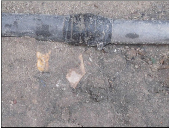
Abb. 1: Selbst repariertes Wasserrohr.
