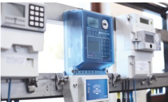
Abb. 5-4: Kabellos dialogfähiger Zähler der von der Firma VOLTARIS eingesetzt wird
