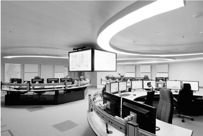
Abbildung 50: Gasnetz-Leitwarte des Unternehmens Ontras GmbH in Leipzig.
