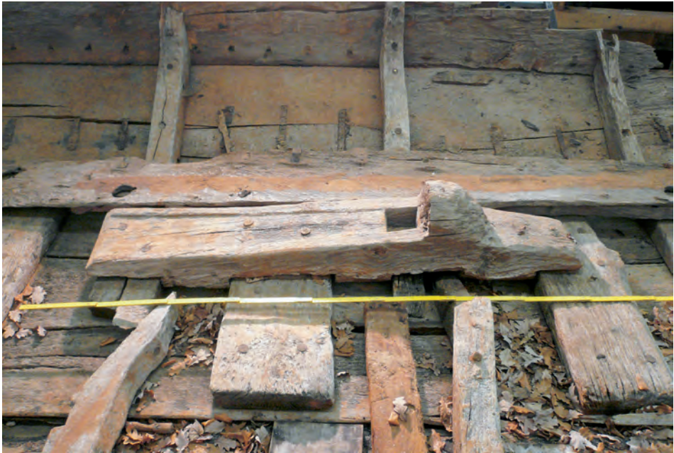
Abb. 11 Bordwand mit Reparatur und Mastschuh bei Kahn B. (Foto: R. Mücke)
