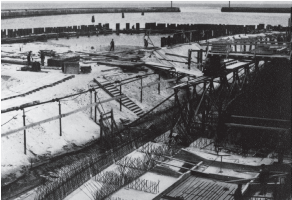
Abb. 11 Baugrube für den Bau von Betonschiffen in Rügenwaldermünde (Darłowko) im November 1942. Zu erkennen ist die Deckplatte der Bau-Nr. 1, der späteren ULRICH FINSTERWALDER. Noch während des Baus der ersten Grube begann man im Sommer 1942 mit dem Aushub der zweiten Grube, deren gerammte Spundwände zu erkennen sind. Im Hintergrund die Molen, die die Wippermündung schützen. (Slg. Gerhard Janke/Archiv DSM)
