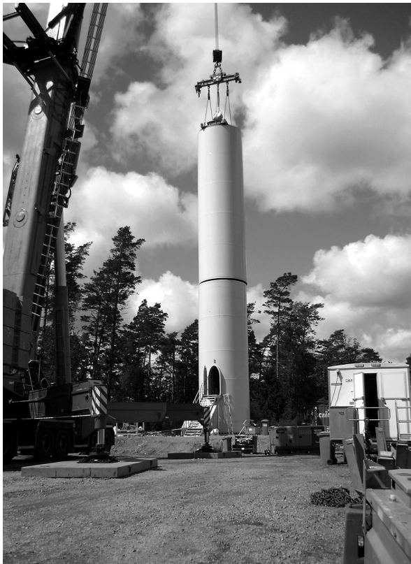
Abbildung 1: Montage von Turmsegmenten bei der Errichtung einer Windenergieanlage vom Typ GE 2,75-103 im Windpark Askombjär bei Falkenberg/Schweden
