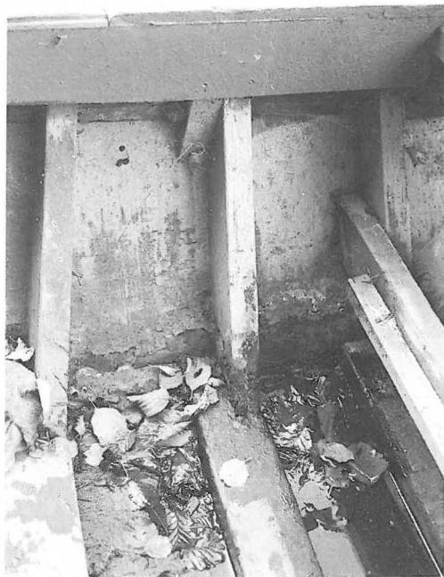
Abb. 4 In Wrangen eingelassene Auflanger verbinden Unter- und Oberbord. Der mittlere Auflanger wird im oberen Teil durch ein Brett verstärkt. Die Auflangerköpfe sind durch Remm und Schandeckel verdeckt
