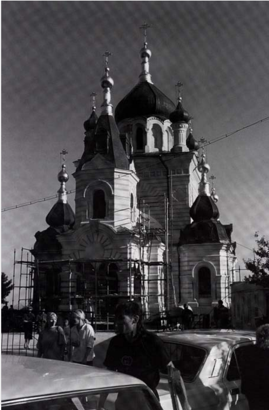
Abb. 6: Restaurierung der russisch-orthodoxen Kirche unterhalb der Baidarskije Vorota, westlich Jalta 1991 (Foto: J. BREUSTE)
