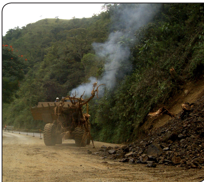
Urabá, Antioquia (abril de 2008). Derrumbe en la carretera al Mar. Fotografía de Maurizio Ali
