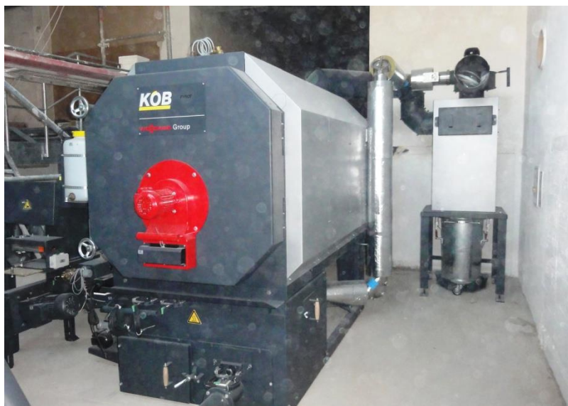
Abb. 12: Holz hackschnitzelkessel der Oberschule Cunewalde
